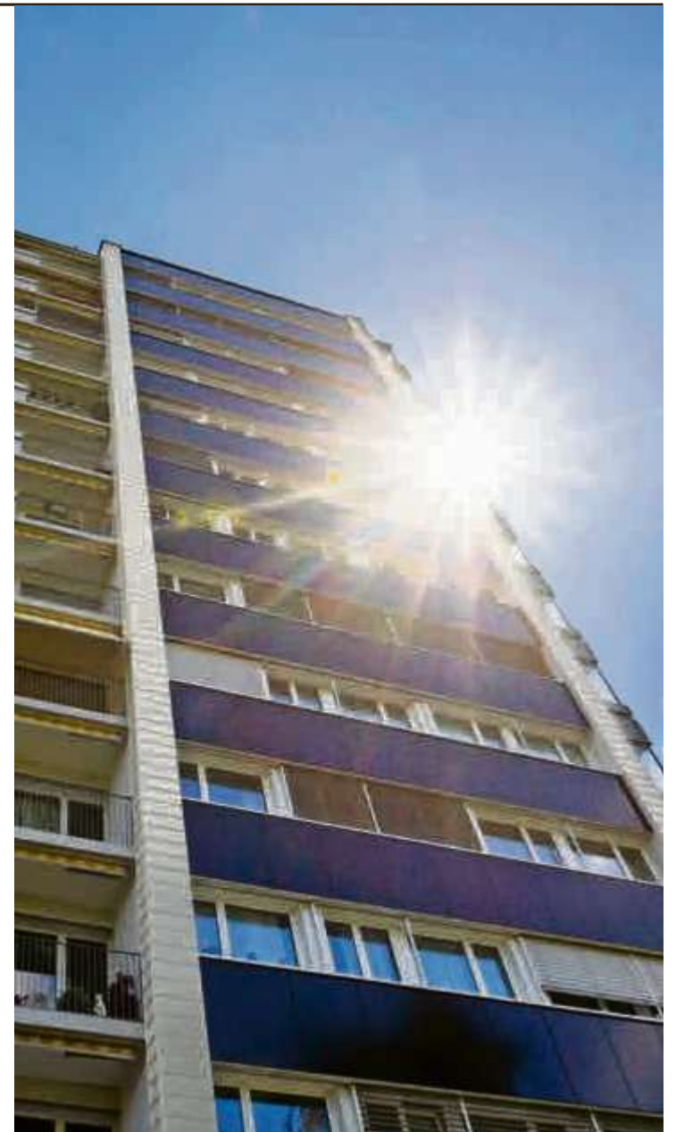
Das 1968 erbaute Haus, das Teil der Wattbuck-Siedlung ist, wurde auf drei Fassadenseiten mit Solarmodulen ausgestattet. Foto: Christian Merz
